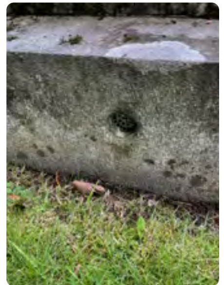
Ventilation på Aspelins gravkammare.
